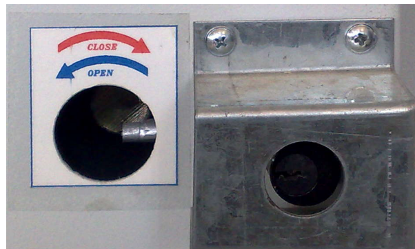
شکل (۲۹): مکانیزم عملکرد و اینترلاک بین کلید قدرت و سکسیونر غیر قابل قطع زیر بار
