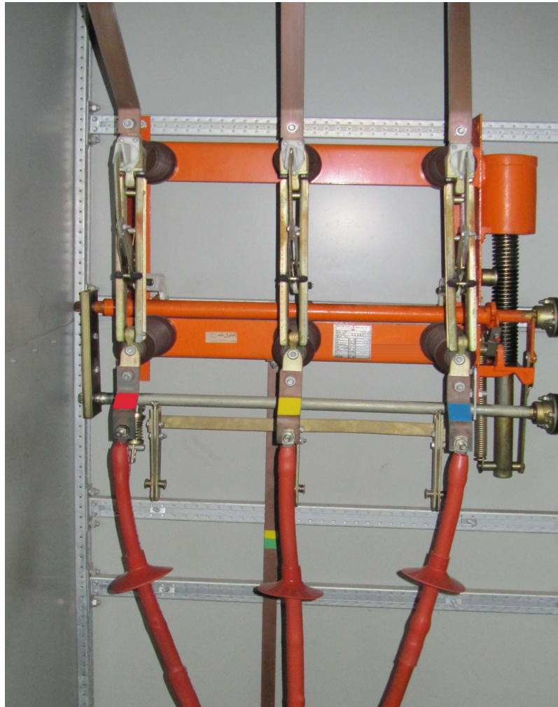
شکل (۵): نمای داخلی یک نمونه سلول سکسیونر قابل قطع زیر بار
